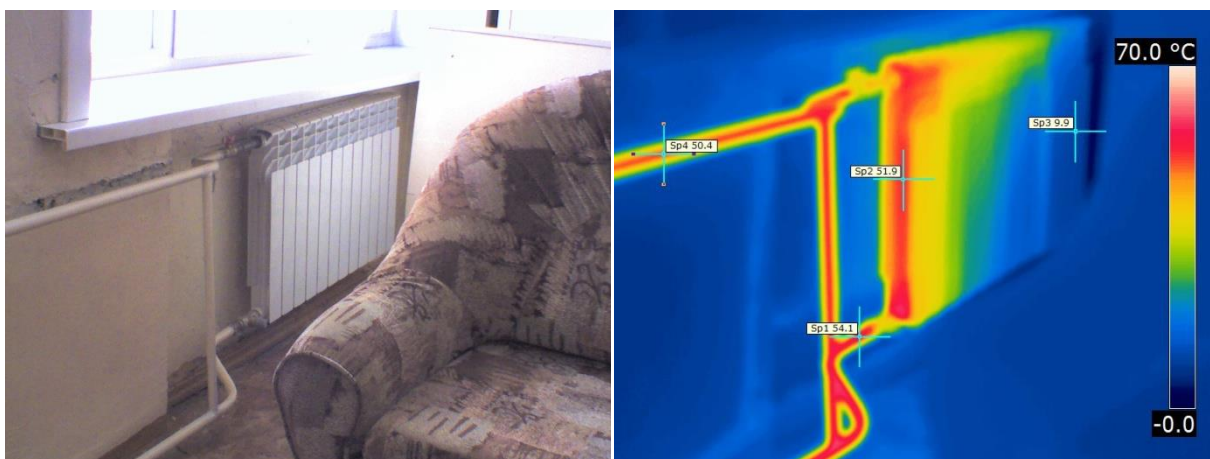
Фото и термо 32. Пример отопительных приборов в классах лабораторного корпуса
