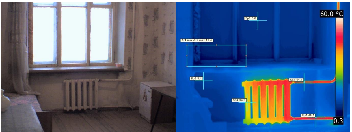
Фото и термо 18. Жилая комната, работа отопительного прибора и состояние окна (стыки запенены, швы заклеены скотчем)
