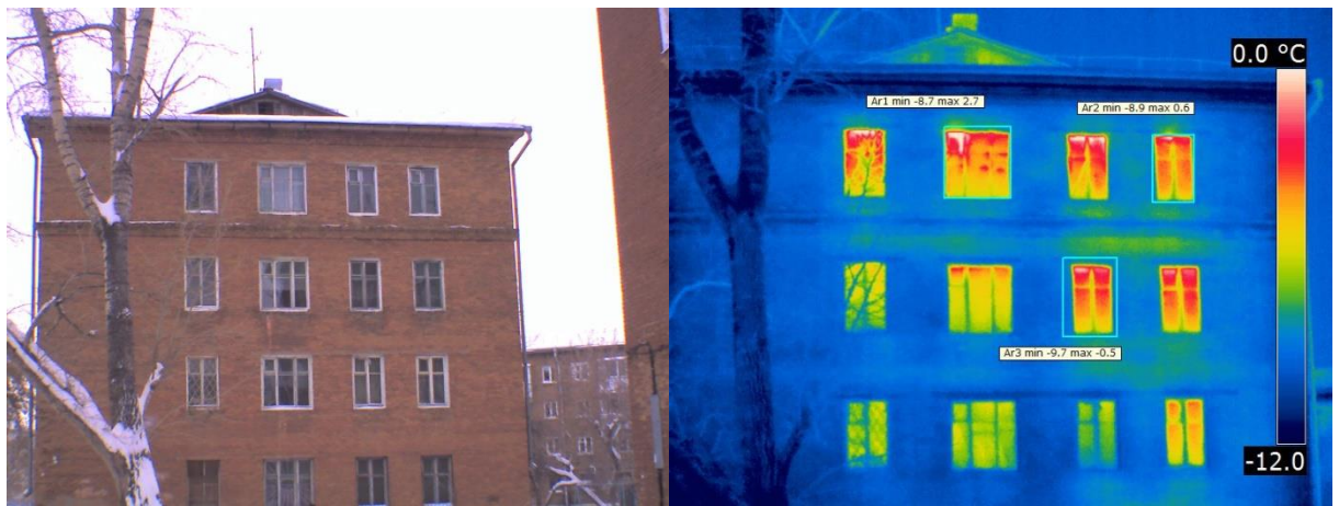
Фото и термо 5. Северо-западный торец 2-4 этажи
