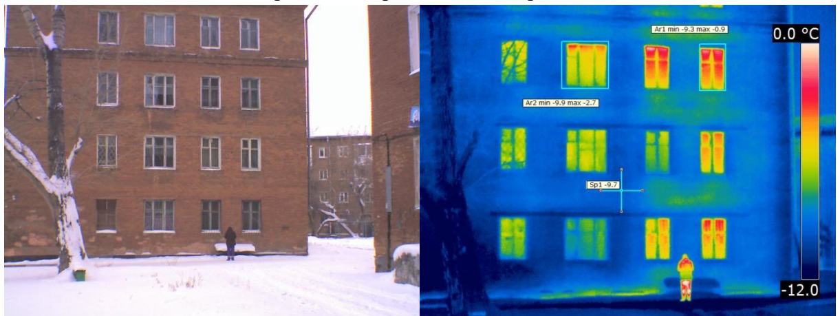
Фото и термо 6. Северо-западный торец 1-3 этажи
